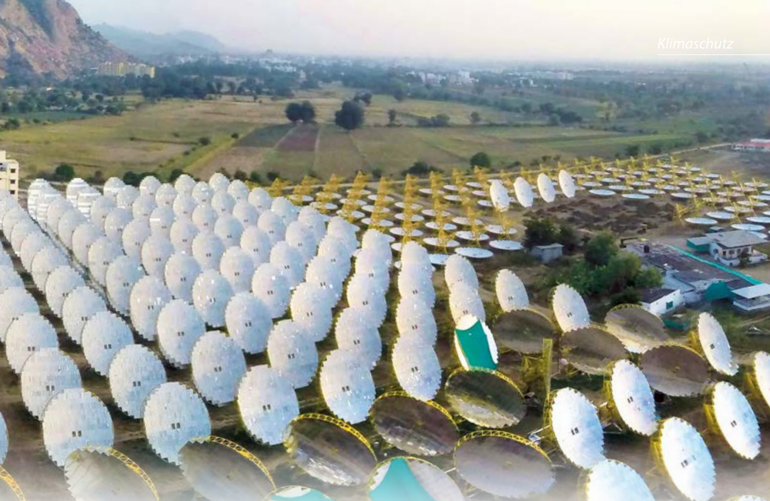
atmosfair-Projekt India One: solarthermisches Kraftwerk in Radjasthan (Indien)
