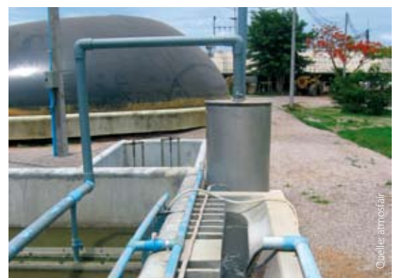
Thailand: Kläranlage und Becken mit Plastikmembran
