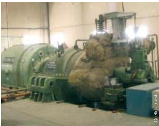
Turbine und Generator
